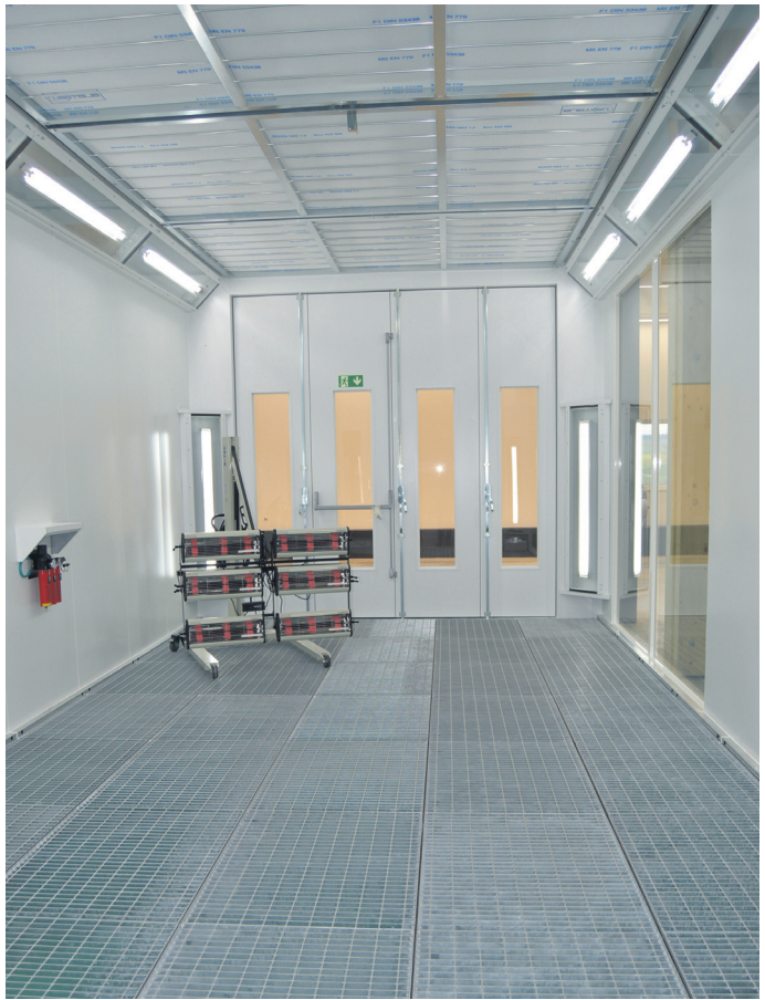
Die modernen Lackierkabine ist auf drei Seiten verglast.
